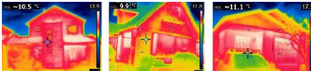
Figura N°5. Fotografías termográficas, puentes térmicos, viviendas analizadas, Temuco año 2015 (Fuente: elaboración propia).
